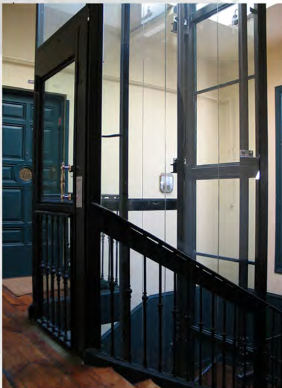
EJEMPLO DE ASCENSOR COLCOADO EN EL HUECO DE LA ESCALERA
